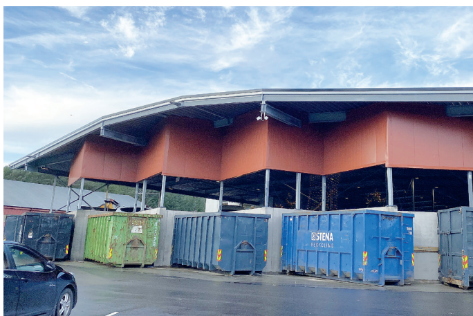
Over containerne er det montert lydabsorberende plater av typen Paroc.
